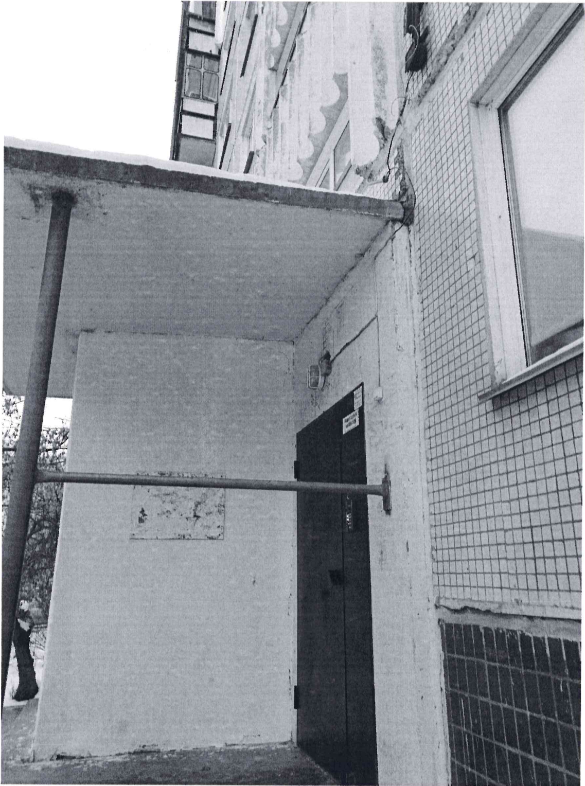
Фото №14. Трещины по линии опоры панели навеса (козырька) и в примыкании вертикальной панели с наружной стеной здания. Подъезд №14.
