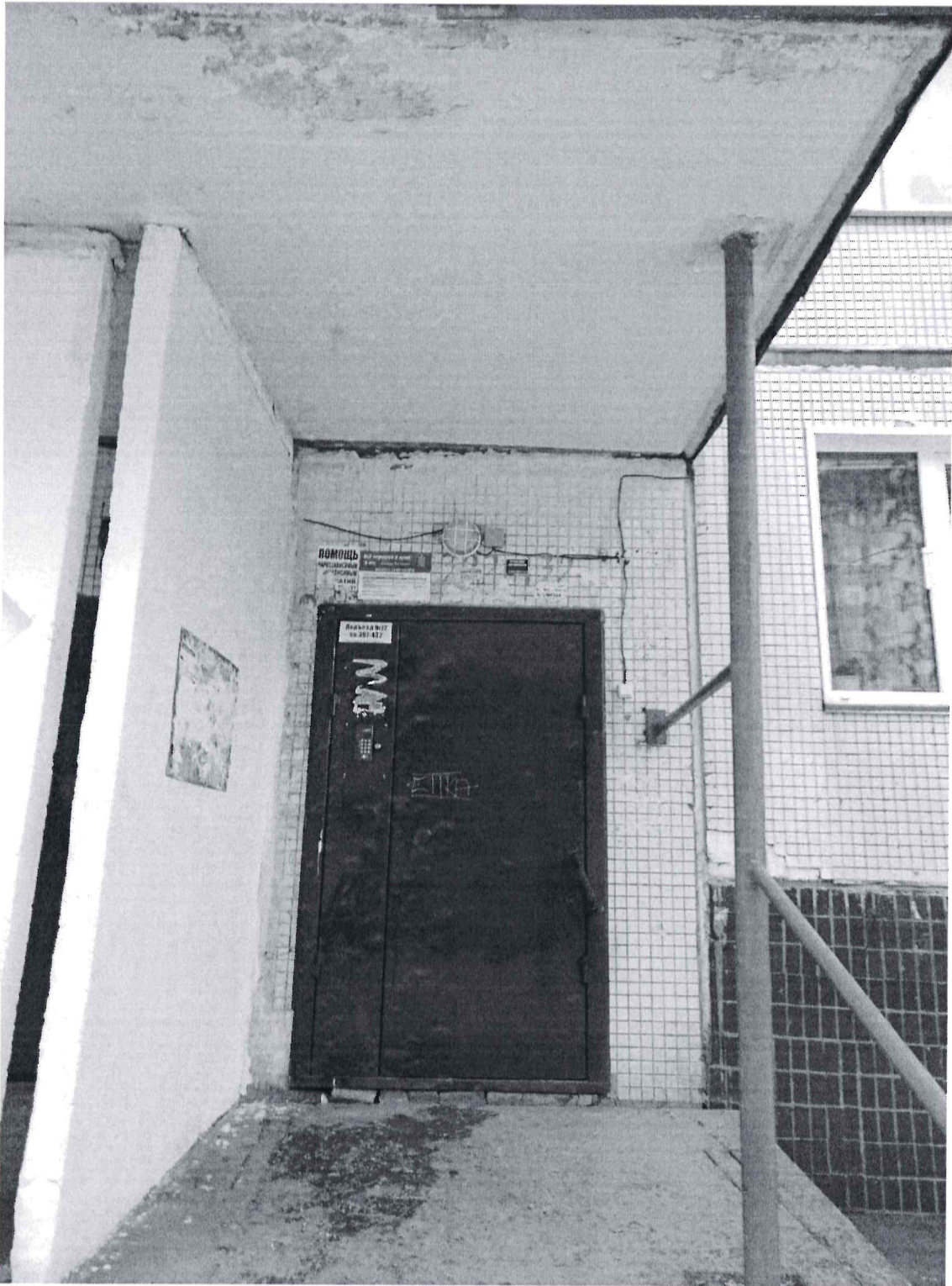
Фото 10. Подъезд №12. Повреждение по линии опоры панели навеса (козырька).
