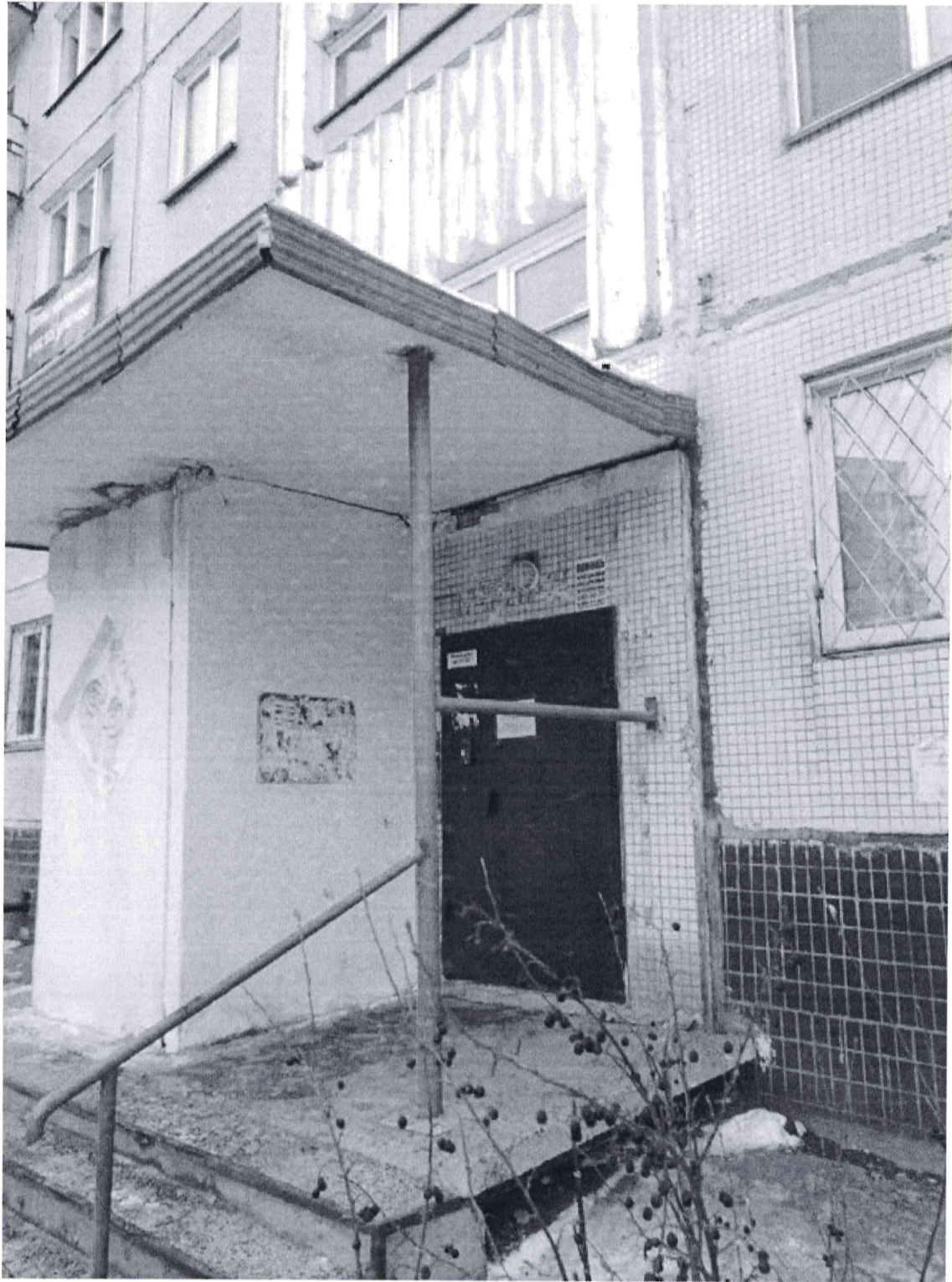
Фото 3. Конструкции входа в подъезд №7. Трещины в примыкании панелей. Смещение панели навеса (козырька) с опорной площадки.
