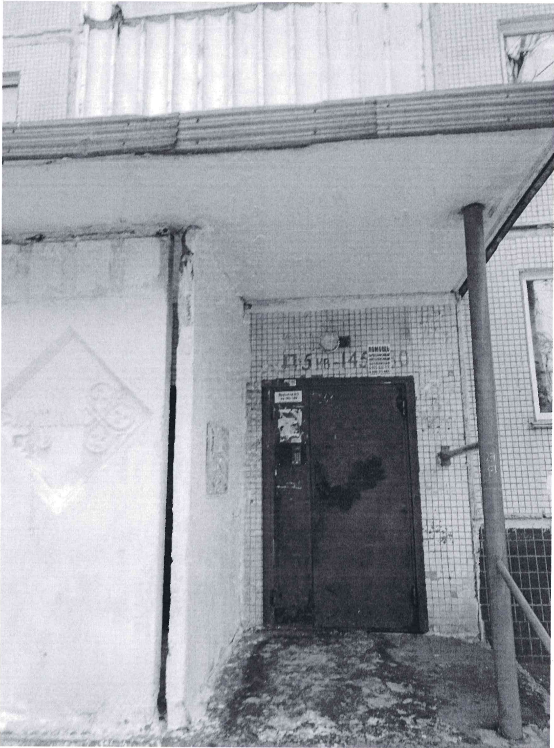
Фото 1. Конструкции входа в подъезд №5. Трещины с небольшим раскрытием по линии опоры панели навеса (козырька).
