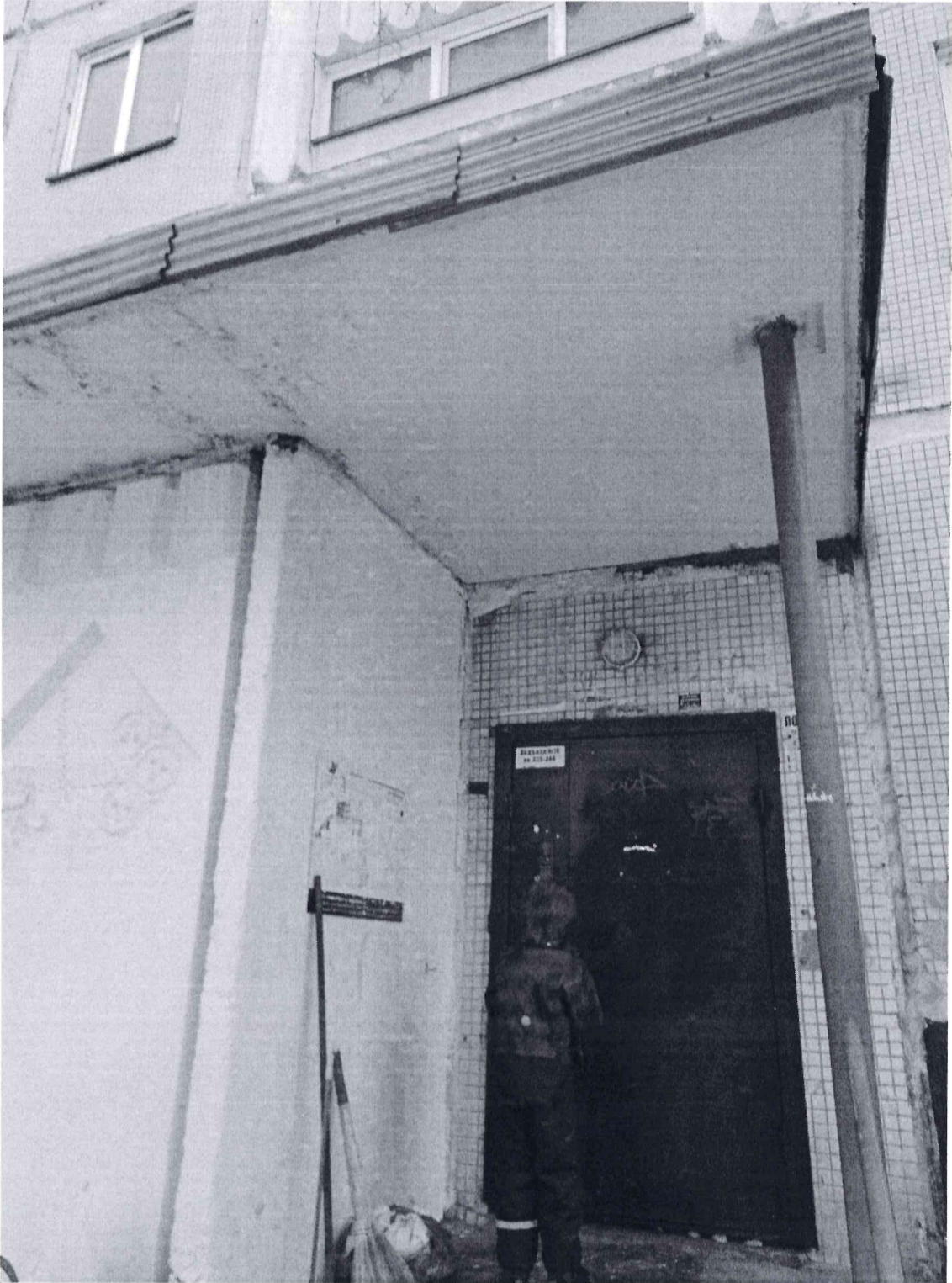
Фото 8. Конструкции входа в подъезд №10. Трещины в примыкании вертикальных панелей и на опоре панели (козырька) навеса.
