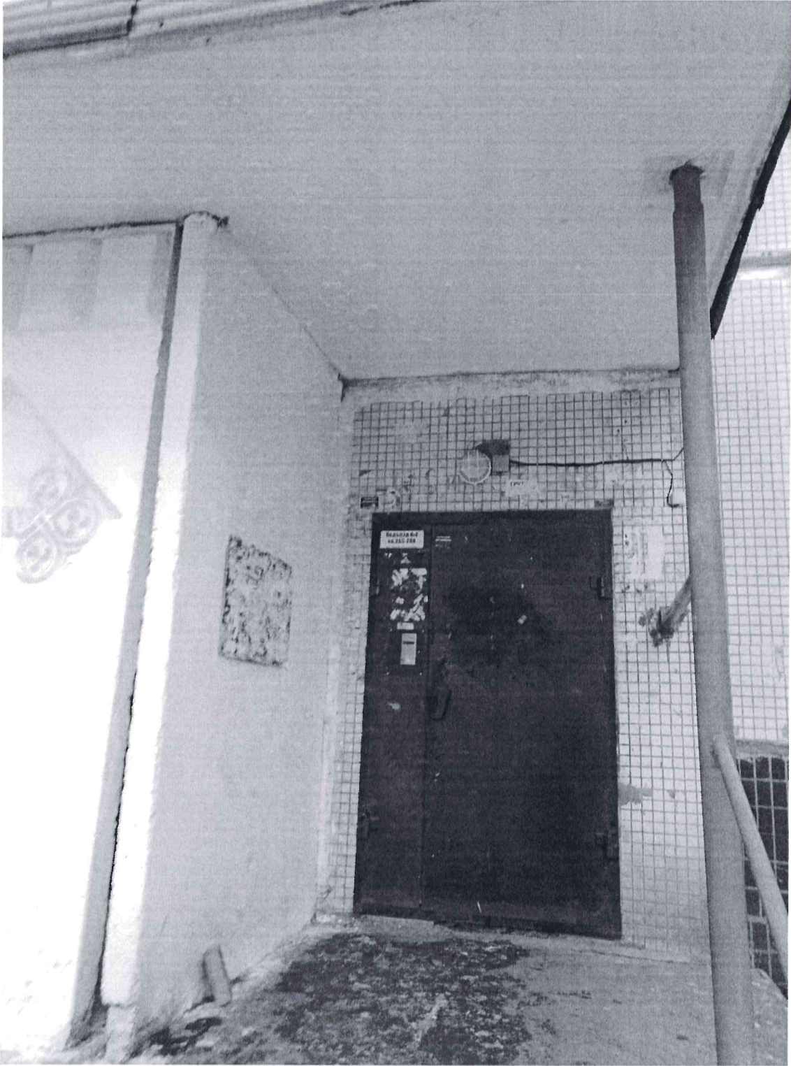
Фото 6. Конструкции входа подъезда №8. Трещины с небольшой величиной раскрытия в примыкании вертикальных панелей к наружной стене здания и по линии опоры панели (козырька).
